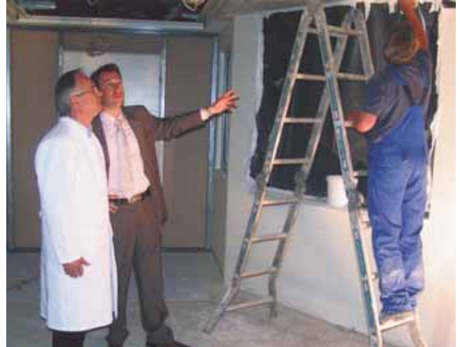
Umfangreiche Installationen sind derzeit noch im 2. Bauabschnitt der Generalsanierung des Klinikums Süd durchzuführen. Im Bild von links Chefarzt Dr. Detlev Fischer und Diplom-Bauingenieur Markus Ostermaier.
