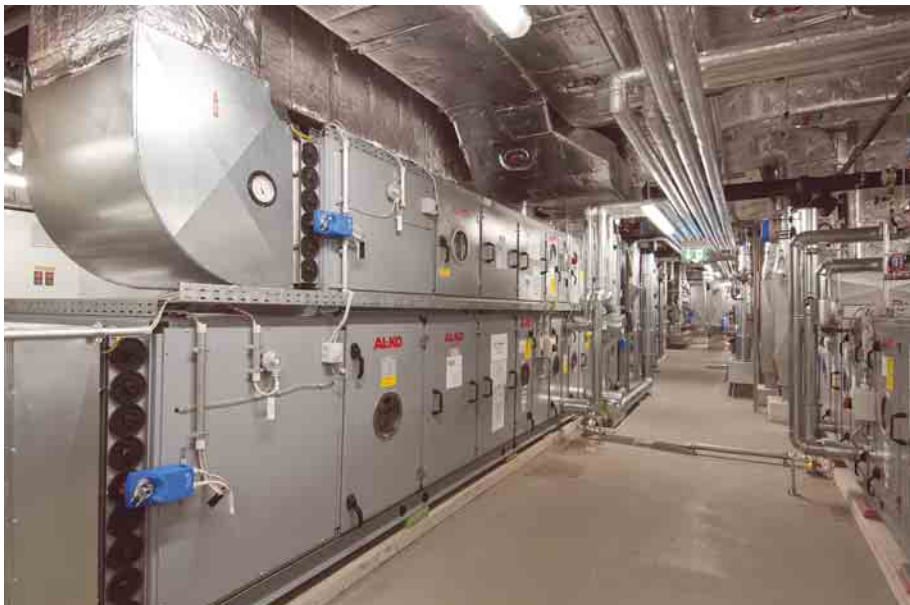
Modernste Klima-Technik auch beim Bau des neuen Dach-Operationsbereiches: Die Luft soll praktisch keim- und staubfrei in die OPs gelangen.
