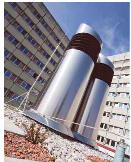
Die riesigen Lüftungsanlagen fördern Luft in die Patientenzimmer.
