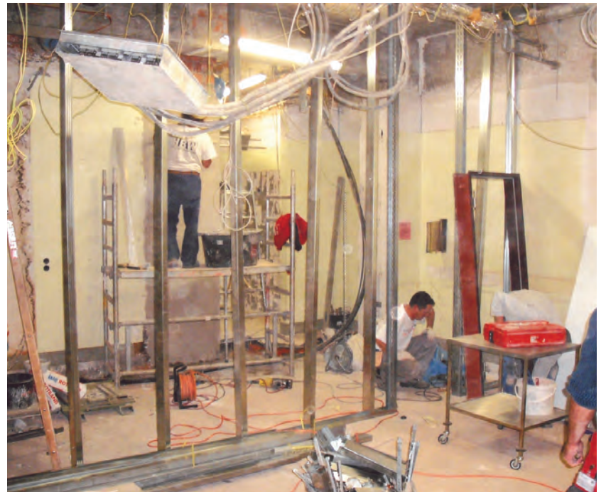
Umfangreiche Umbau- und Installationsarbeiten waren nötig, ehe schließlich die neue Angiographieranlage installiert werden konnte.
