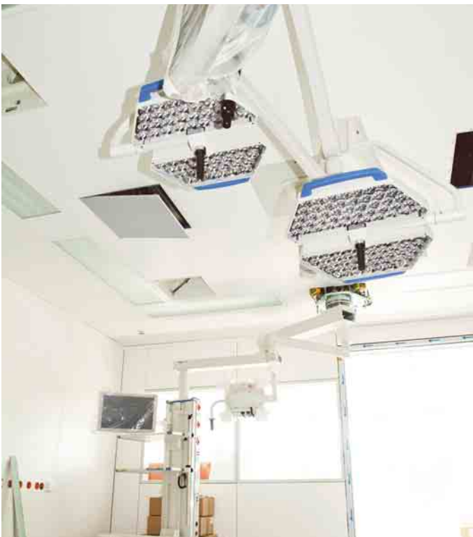
Nicht nur die großen OP-Leuchten sind an der Decke montiert – auch Geräte und Monitore hängen in den neuen Dach-OPs griffbereit in Halterungen. Ärzte und Pflege sind mit den sechs neuen Sälen sehr zufrieden.
